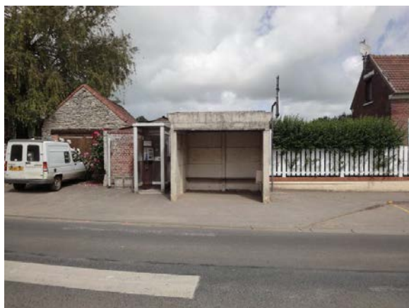
Abri-bus communal rue de Montdidier
